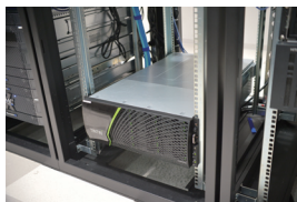
データセンター内の Tintri VMstore
